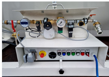
Steuerschrank und Wassersystem
