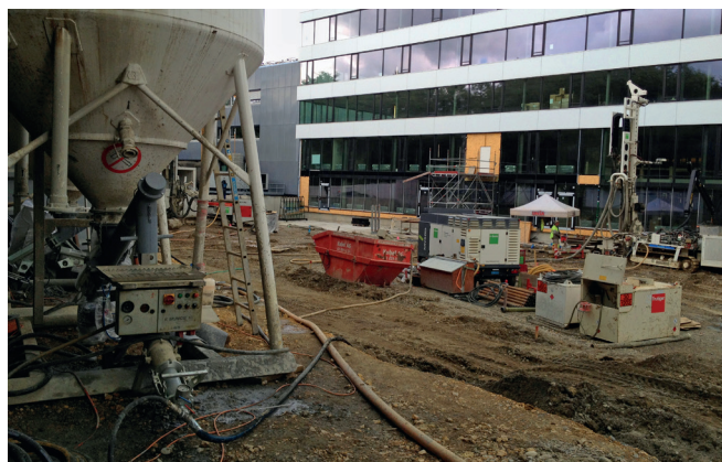
Automatisierte Silo- und Pumpentechnik
