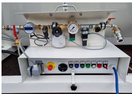
Steuerschrank und Wassersystem
