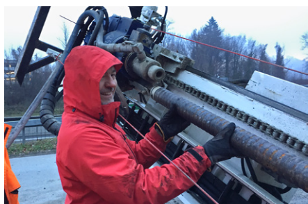
4. Monter une rallonge sur l'extrémité forée du KÜPS ®. Ensuite revisser sur le marteau de forage, démarrer l'injection et poursuivre le forage jusqu'à atteindre à nouveau la profondeur de forage.
